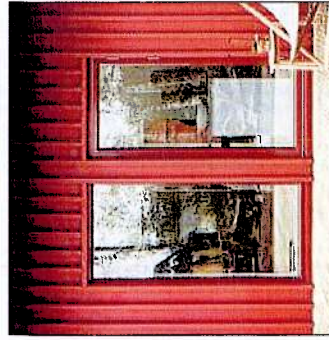
Stadsvillorna har stora glaspartier mot privat gård. Glaspartier passas in i listverk.
